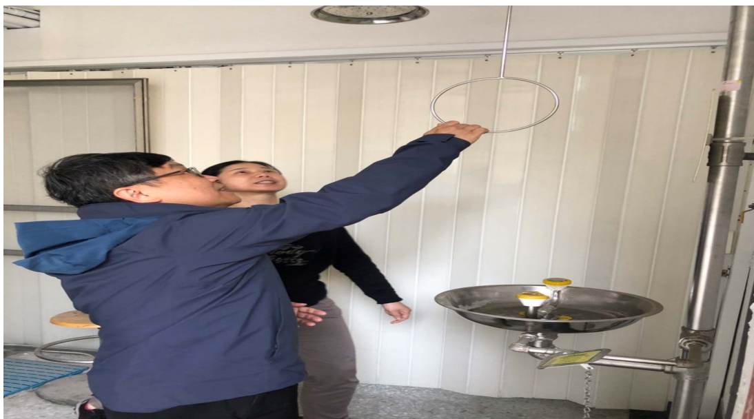
◎ 照片 1 簡述：職醫檢視實驗室之沖淋設備
